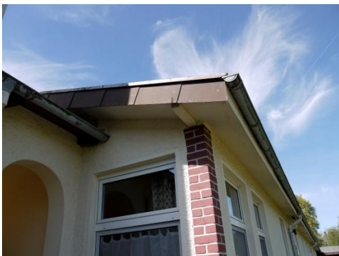
Abb. 11: In der Blechverkleidung gibt es schmale Spalten und kleinere Hohlräume.
